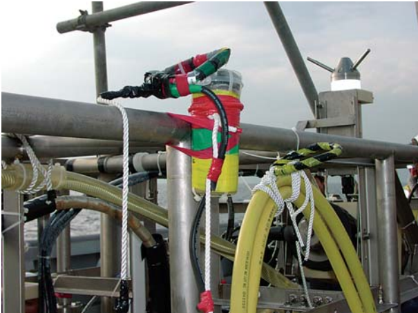
図5 海底ケーブルに取り付けられたシーアースステーション 海底設置後、海底に設置された
